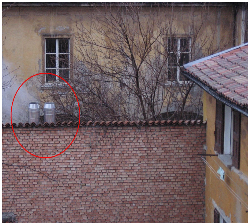
Fig. 3. Esempio di posizione errata dei camini
