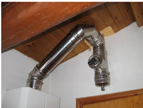
Fig. 3. Condotto del generatore di calore.
