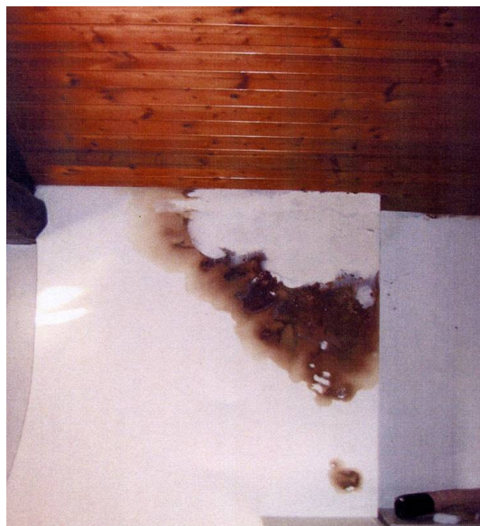
Fig. 2. Macchie sul muro.
