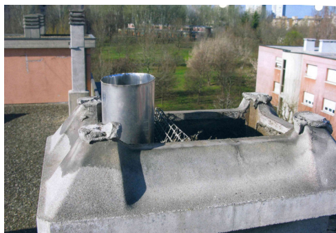
Fig. 3. Parte terminale della canna collettiva ramificata.
