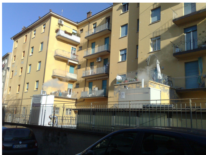
Fig. 5. Installazione di caldaie a condensazione per esterno con bocche dei camini esattamente a 10 m di distanza.
